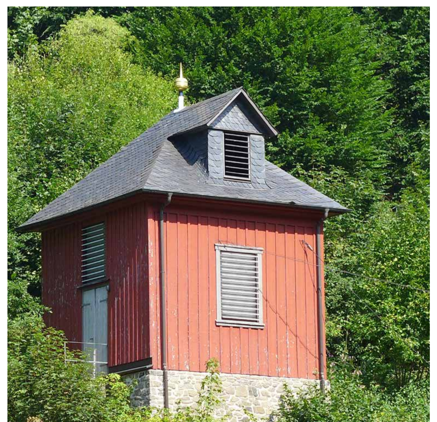
Grauwacke im Sockel des Glockenturms Greywacke in the foundations of the bell tower
